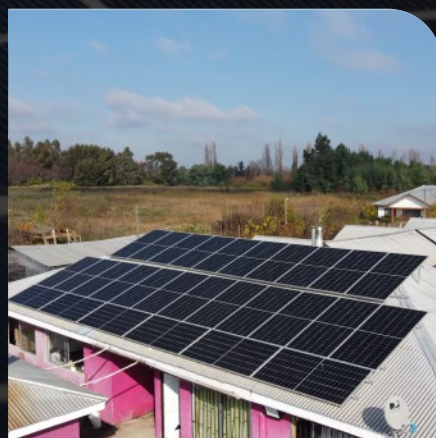
Sistema Ongrid 15 kW Trifásico - Talca
