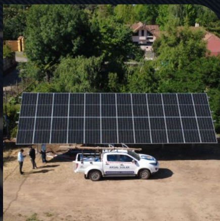
Sistema Ongrid 15kW Trifásico - Talca
